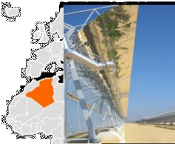
Espejos cilindro-parabólicos en Hassi-R'mel Argelia ISCC 150 MWe (20 MW solar)
