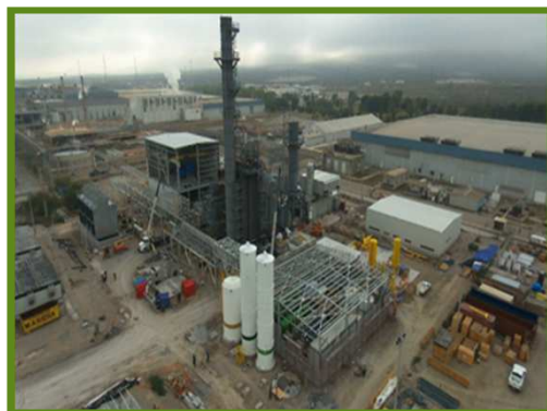
Cogeneración Ramos 50 MW, COD 2016
