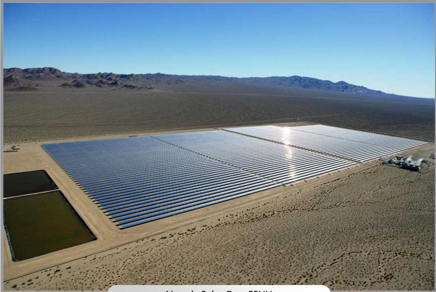
Nevada Solar One, EEUU
