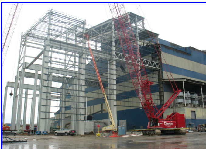
Estructura Horno Eléctrico N°2
