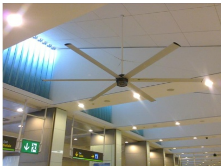
Imagen 14. Ventiladores HLVS. Aeropuerto de AS Madrid/Barajas
