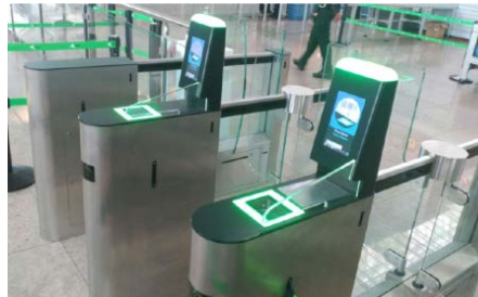
Imagen 29. Nuevas puertas automáticas de lectura de tarjetas de embarque. Aeropuerto de Barcelona
