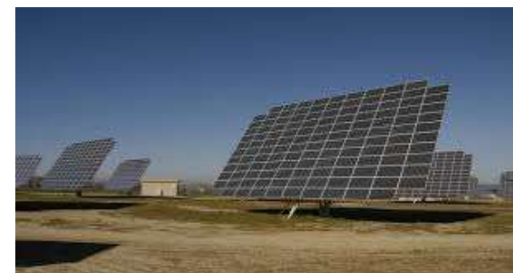
Planta solar Fotovoltaica en Los Prados en Coria. Cáceres. (España)
