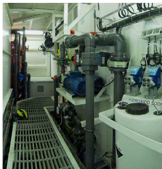
Befesa Agua, planta piloto de sistemas avanzados de pretratamiento
