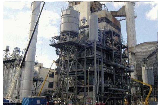
Viana do Castelo (Portugal) Detalle Instalaciones de Cogeneración
