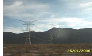
Red de 400 KV Durango Sur-Torreón Sur (México) 217 km; proyecto llave en mano
