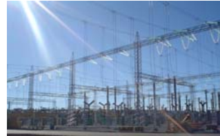
Subestación; Salamanca 400 KV (México) Proyecto llave en mano
