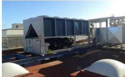
Imagen 11. Nueva enfriadora del módulo A de embarque en Palma de Mallorca
