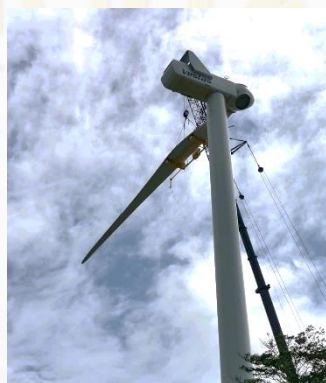
Parque eólico Toabré (Panamá) 66 MW
