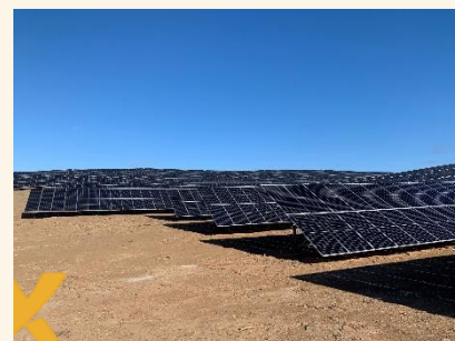
PV Calañas (Huelva) 4,5 MWp
