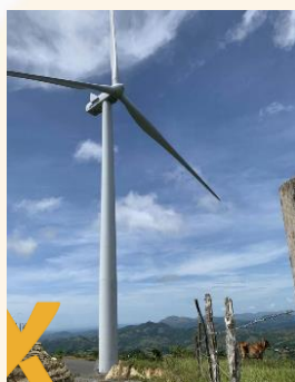
Wind farm Toabré (Panamá) 66 MW
